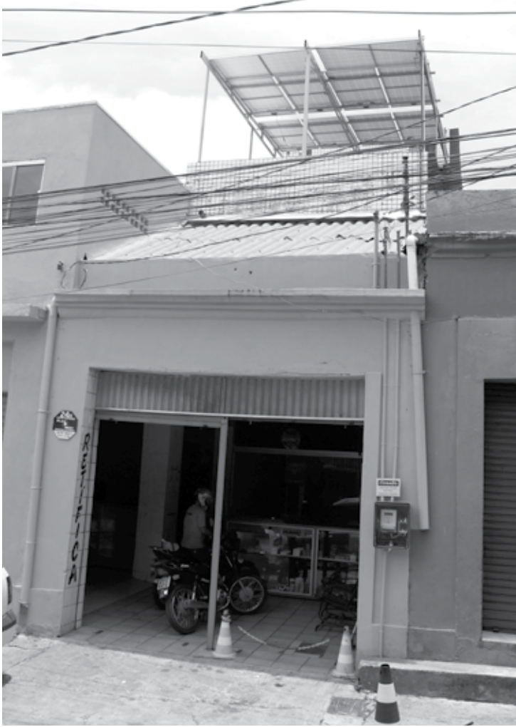
Na retífica, foram instalados 20 painéis solares, com potência de 330 watts cada
